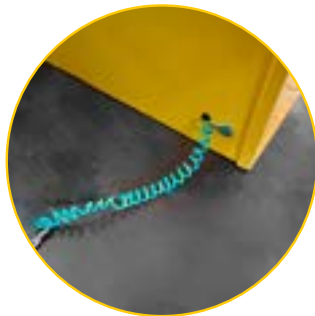
Sistema de ligação à terra
